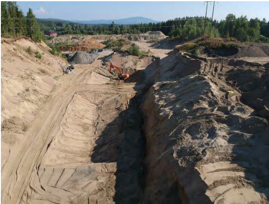
Figur 7. Bilde viser sedimentasjonsbasseng og infiltrasjonsbasseng (der gravemaskinen står) (foto: Herstua Miljø AS).
