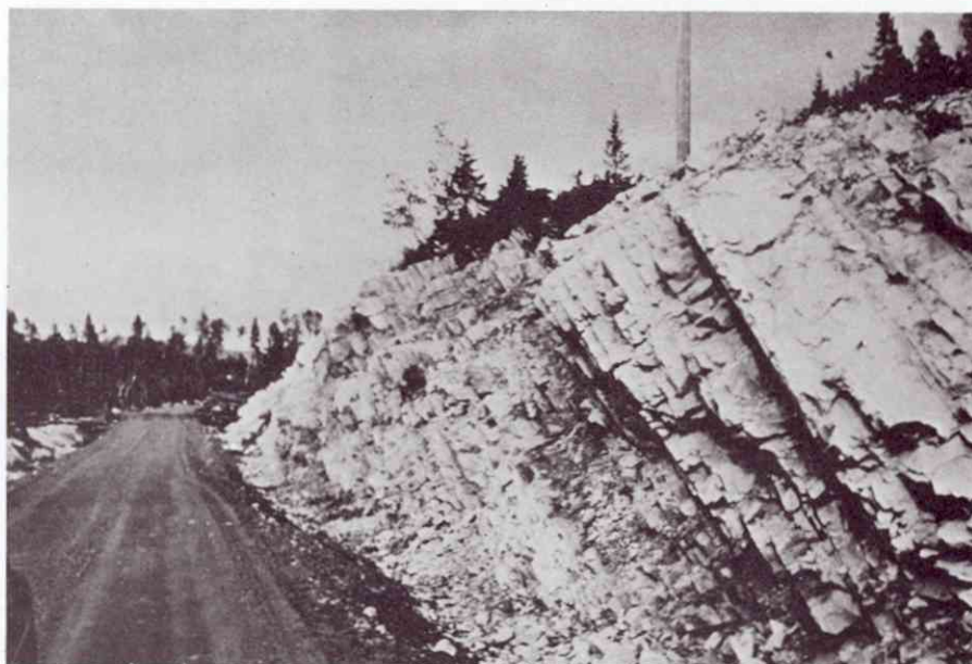
Oppsprukket dolomitt, veiskjæring Elsfjord-Seljeli.
