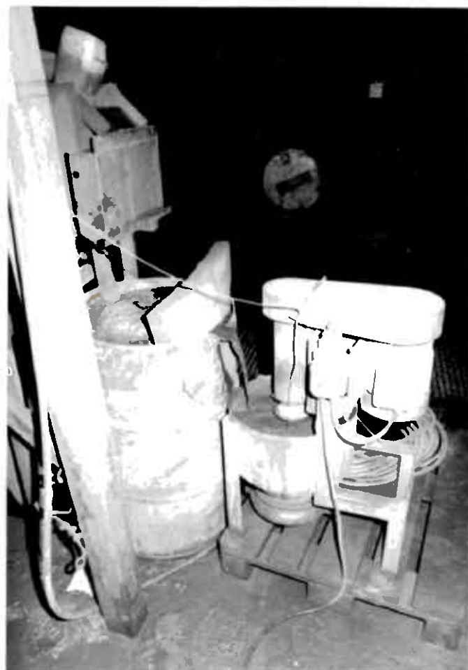
Fig. 3.2 Skillekasse, "grovavskiller" og tilførselsspumpe
