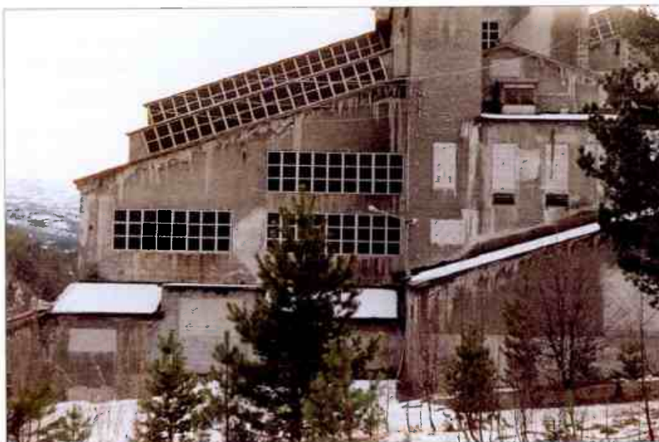
Bilde fra 1992. Vindusglass er erstattet av plater og omramming i impregneret materiale.
