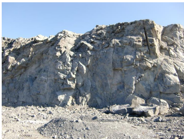
Fig. 6. Bildet viser eksempel på sprekkdannelser.
