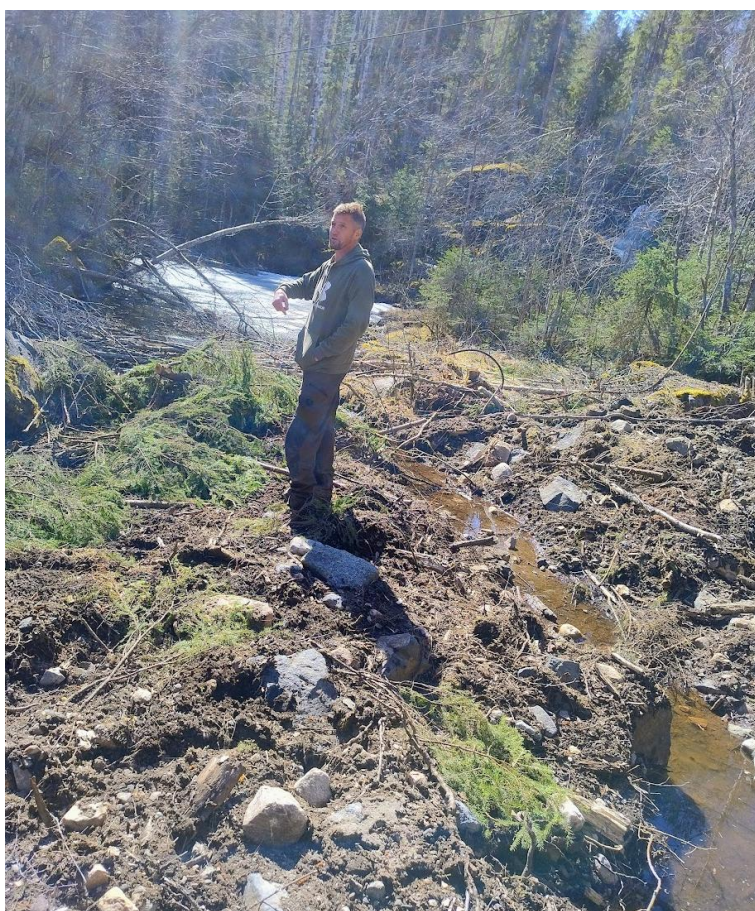
Figur 23 Fra dammen er det gravd en liten grøft som renner mot Måsåfløgsjøen.
