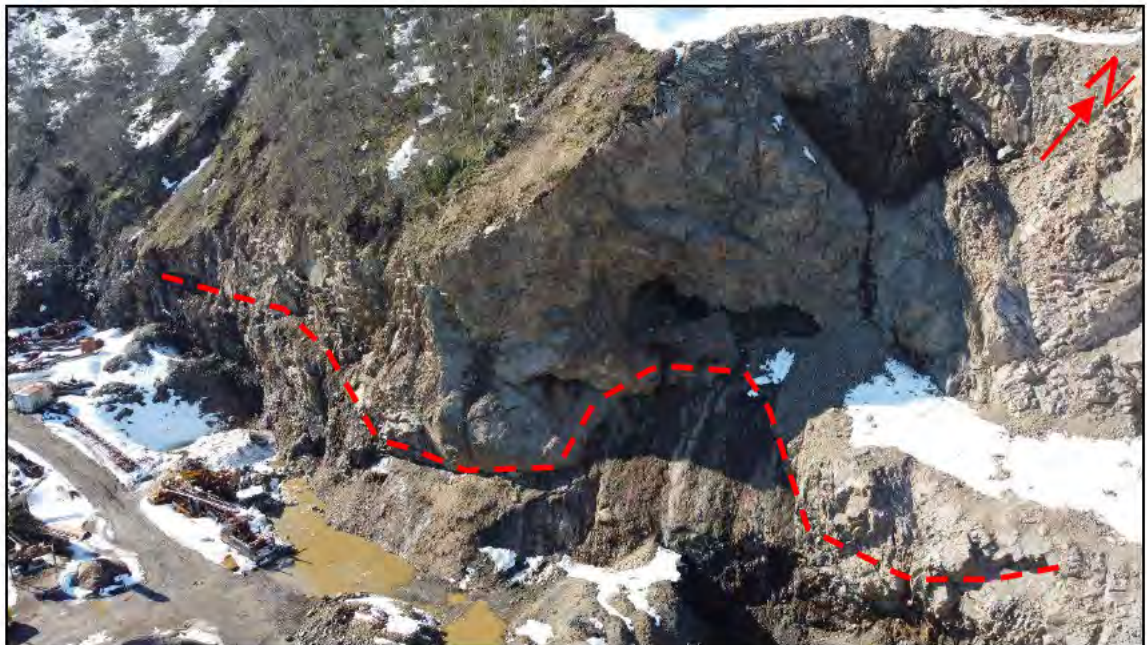
Figur 5: Markant utgående sprekk med tilsvarende orientering som sprekkesett 1 som gir størst utfordring med totalstabiliteten. Markert med rød stiple linje.
