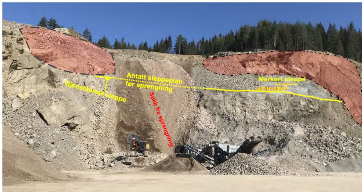
Figur 4 Det registret en markert sleppe med glatte overflater som faller 40° mot N150°Ø. Røde soner viser bergpartier med potensielle ustabile bergmasser som kan rase ned langs sprekkplan.
