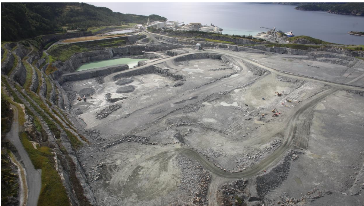
Bilde 1: Sikringshyllene jordkles løpende.
